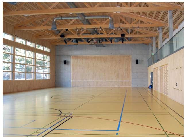
Genügend Platz für die Lüftungsrohre dank der Fachwerkkonstruktion
