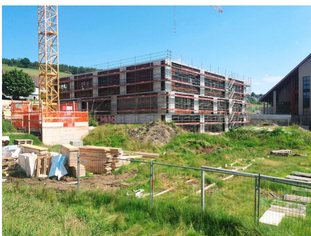
Des délais de construction plus courts grâce au bois (photos de Roger Frei)
