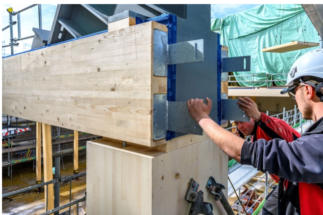
Combinaison high-tech de poutres en acier et de bois. Travail de précision sur le chantier
