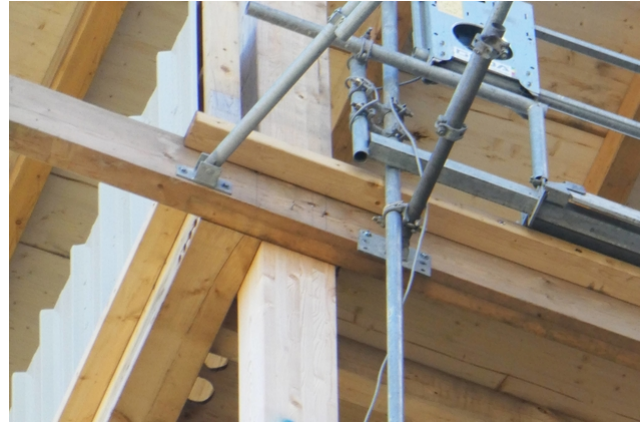
Fire protection transom per floor
